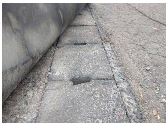
側溝損傷状況
